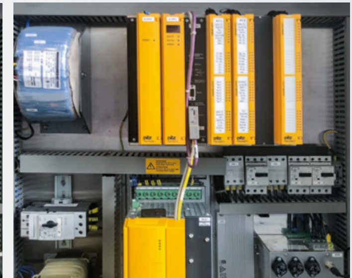
Auf den neuesten Stand gebracht: Blick in den Technikraum einer beispielhaften Tablettenpresse vor (links) und nach der Modernisierung (rechts).
